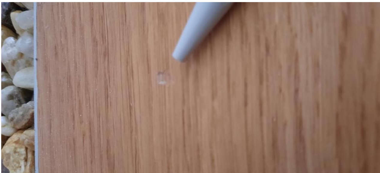
Zoom – zone entrée sdb – interrupteurs – marque 1
